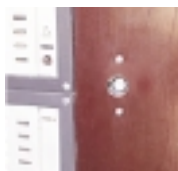
osadenie DP v blízkosti tlačidlového tabla - exteriér
